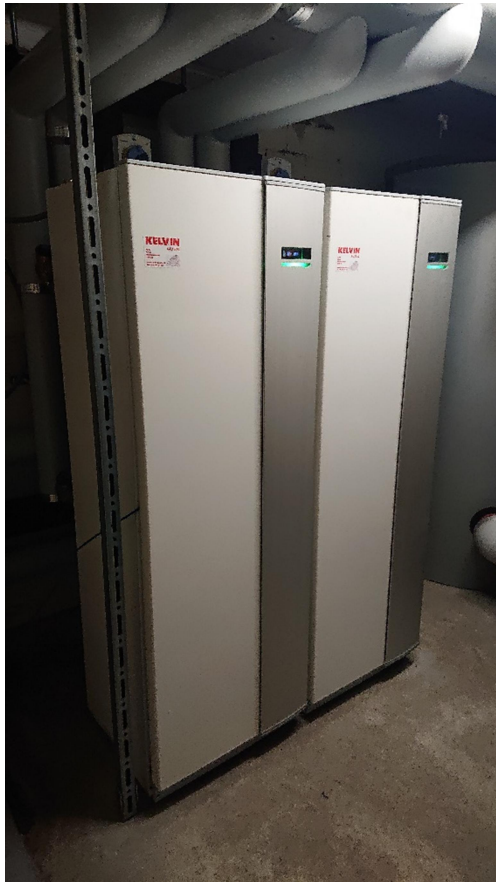
Bild 2 Wärmepumpen NIBE im Nebenraum
