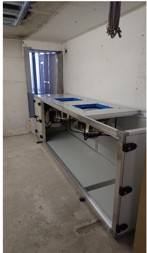
Bild 1 Lüftungsmonobloc in der Bauphase mit 4 EC-Ventilatoren
